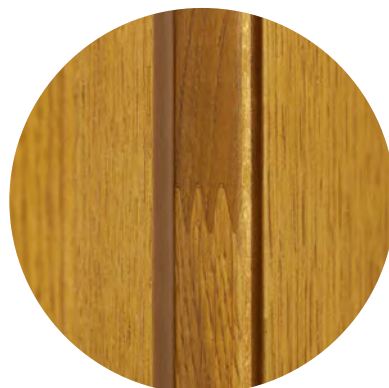
Różnice kolorystyczne łączeń**
